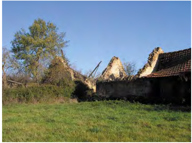
Givarlais : une grange qui a perdu son toit. Le pignon de gauche va s'effondrer si rien n'est fait.
