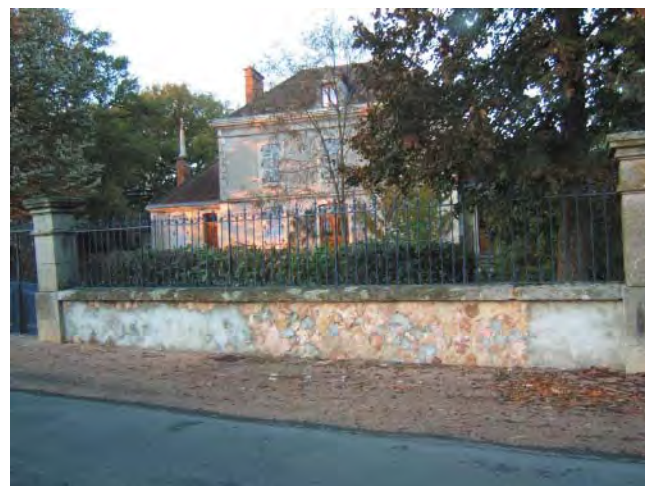
Audes : le muret maçonné est bas, il laisse apprécier la maison de maîtres au travers de la ferronnerie. A noter les reprises en enduit ciment qui le dénaturent totalement.
