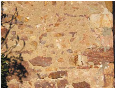
Des joints largement beurrés qui recouvrent presque entièrement les assemblages.
