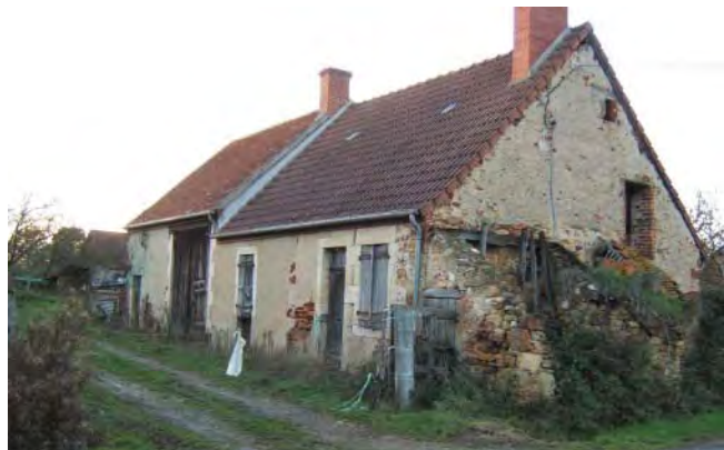
Audes les Maisons : une maison et sa grange accolée. Un exemple en cours de dégradation : l'appentis côté route n'a plus de toiture, les enduits sont dégradés alors que le toit semble entretenu.
