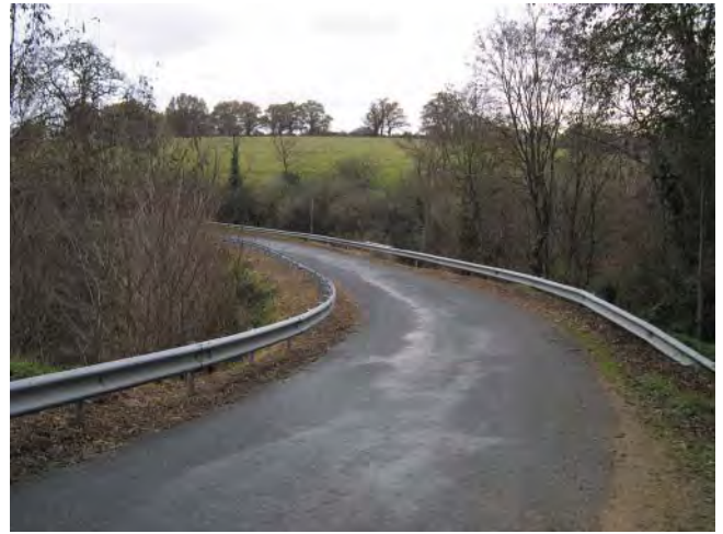
RD241 à Audes : les glissières métalliques répondent à des impératifs de sécurité mais elles s'imposent fortement aux regards et contrastent avec les ambiances rurales du territoire.
