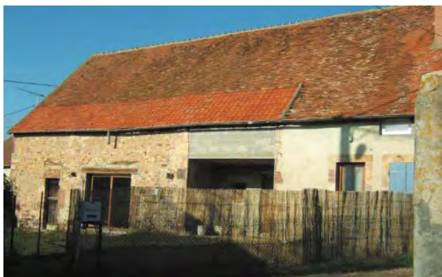
La porte de la grange est partiellement obturée en partie haute : retombée en parpaings. La façade est traitée en retrait avec création d'une porte et une fenêtre au fond. La façade est un peu déstructurée.
