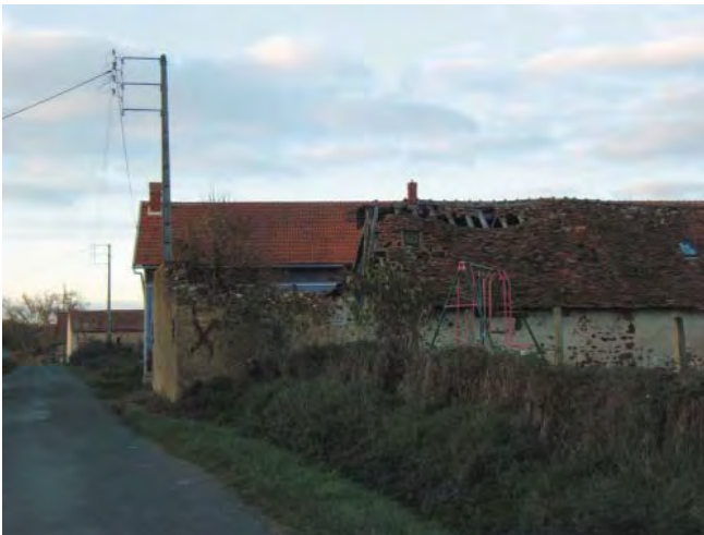
Audes : La toiture est en partie effondrée et permet à l'eau de s'infiltrer.
